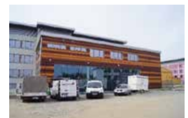
Der Schulbetrieb hat noch nicht begonnen, aber die Schulsanierung der 2. Oberschule schreitet voran.
