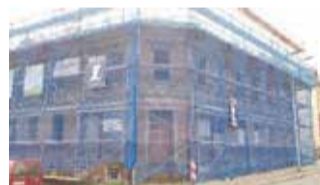
Die Arztpraxis und das neue Wohngebäude an der Jahnstraße nehmen langsam Gestalt an.
