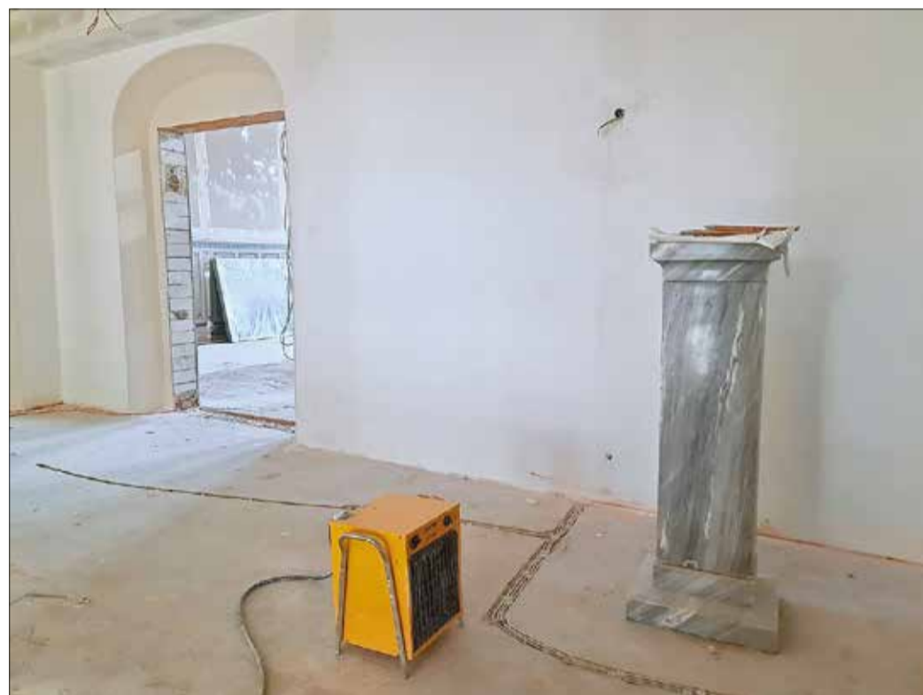
Eine Tür ohne Zarge, ein Boden ohne Belag, ein Sockel ohne Lessing, aber in warmer Umgebung - „Baustellenidylle“ im Altgebäude der Lessingschule am 29.03.2022.
