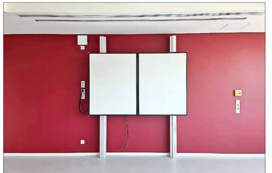
Blick ins Innere des Erweiterungsneubaus: Die digitalen Tafeln sind da und montiert – 25.07.2022.
