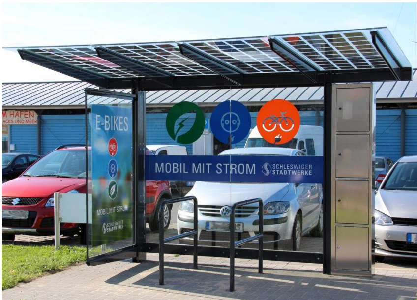
Abb. 37 Beispiel einer E-Bike/Pedelec-Ladestation an einer ÖPNV-Haltestelle
