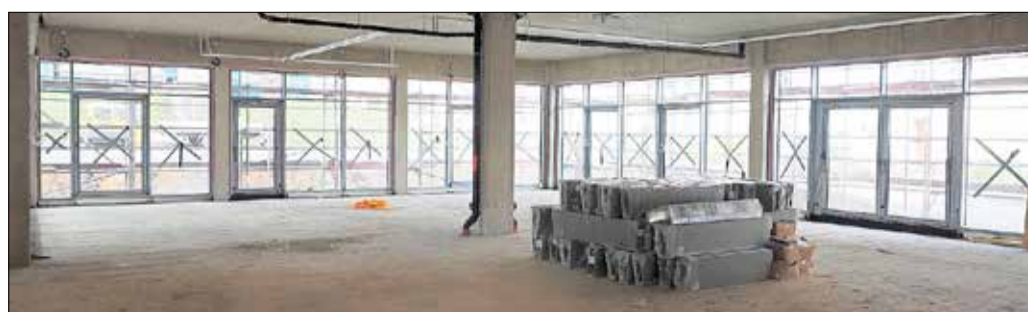
Erweiterungsneubau an der Lessingschule: Ein Blick in die zukünftigen Räumlichkeiten der Stadtbibliothek (23.04.2021 – Hier wird sich inzwischen schon wieder einiges verändert haben.)
