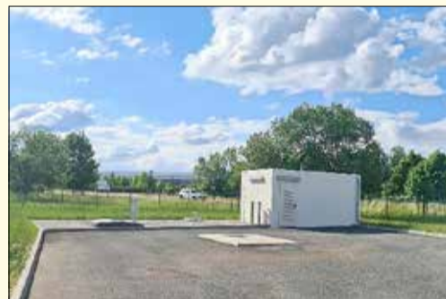
Abpumpstation an der S94
