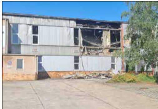
Der Schaden auf dem Werksgelände an der Nordstraße ist groß.
