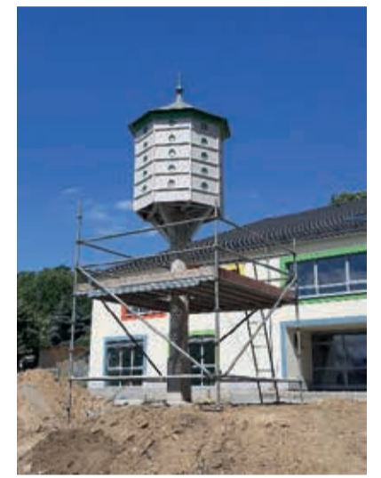
Eingerüstet von Gerüstbaufirma Gneuß und aufgebaut von der Fa. Natursteinmontage Ziesche steht jetzt das Taubenhaus an seinem vorgesehenen Platz.
