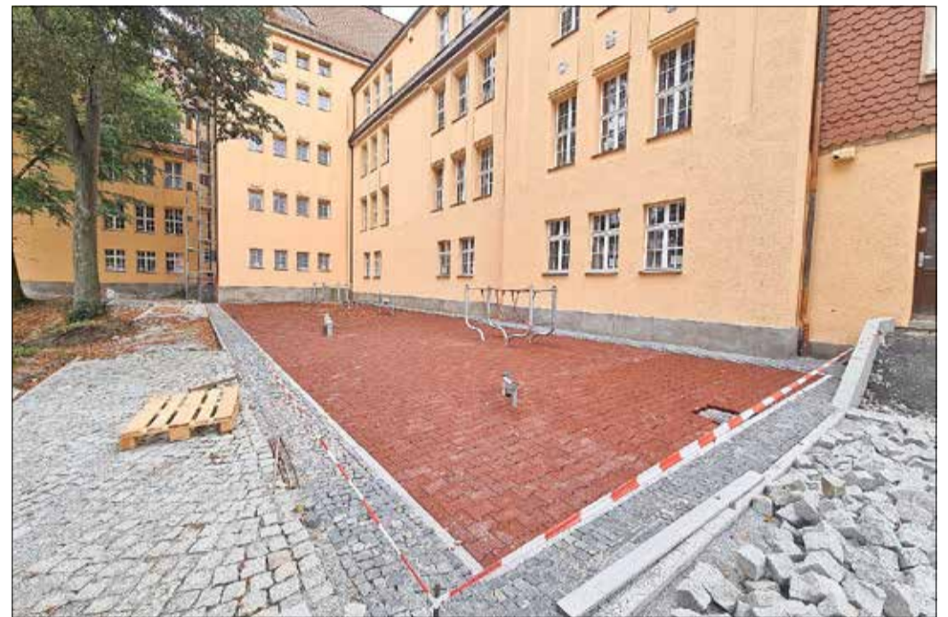
Der Innenhof zwischen historischem Gebäude und Erweiterungsneubau nimmt an dieser Stelle Gestalt an – Spielmöglichkeit für die Pause (19.09.2021).
